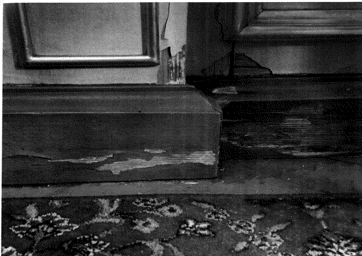
Fot. nr 3 – Chełm, Cerkiew prawosławna p.w. Jana Teologa, Ikonostas. Zniszczenia partii cokołowej. Wyk. M. Podgórska - Makal. Czerwiec 2016.
