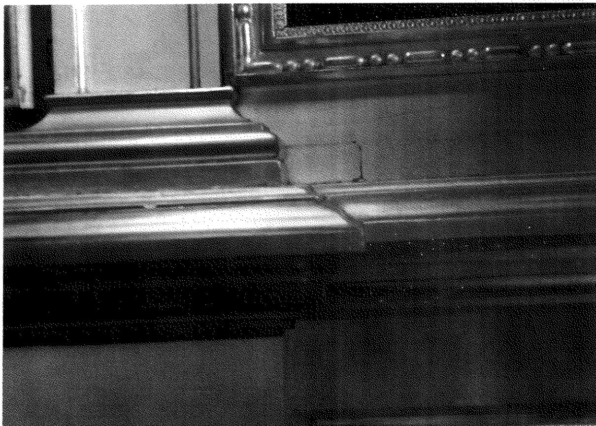
Fot. nr 5 – Chełm, Cerkiew prawosławna p.w. Jana Teologa, Ikonostas. Pęknięcia w pasie ikon Namiestnych. Wyk. M. Podgórska - Makal. Czerwiec 2016.
